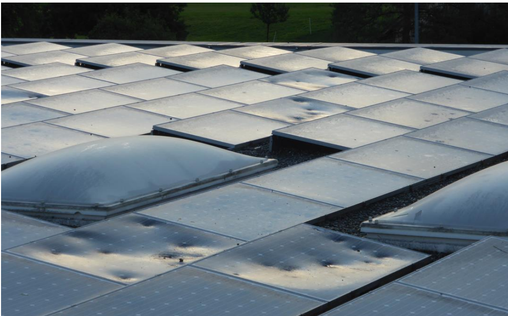
Panels der Anlage Schulhaus E+F
