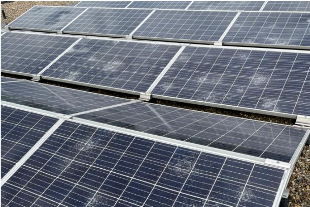
Panels der Anlage Schulhaus D
